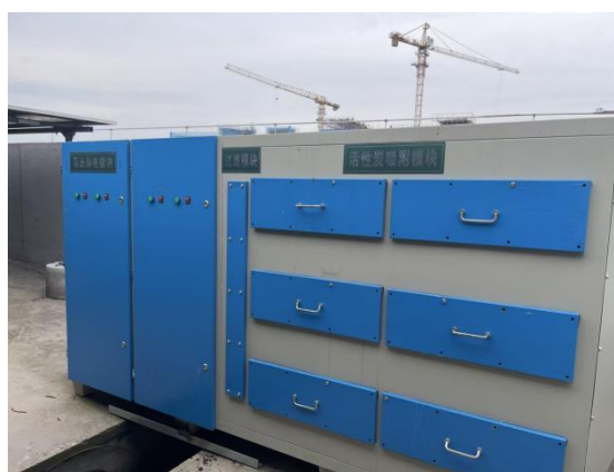
有机废气处理设施 (静电除油+干式过滤+活性炭吸附)
