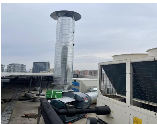
有机废气排气筒（DA001）标牌
