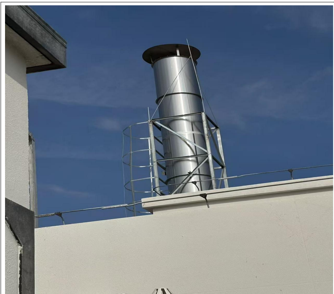
油烟废气排气筒
