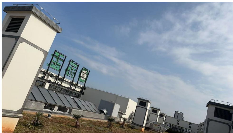
汽车尾气排放竖井
