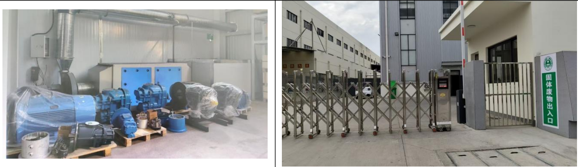
废气处理设施
