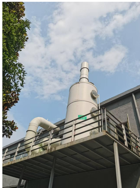
废气设施及排放口
