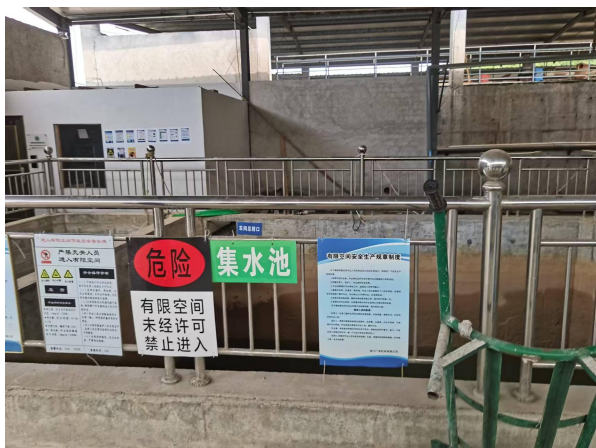
污水站集水池
