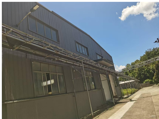
架空的污水管道
