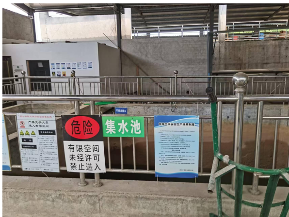
污水站集水池
