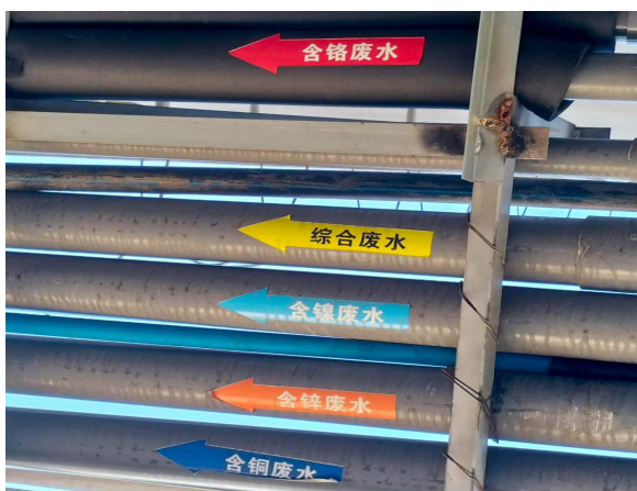
废水架空管道
