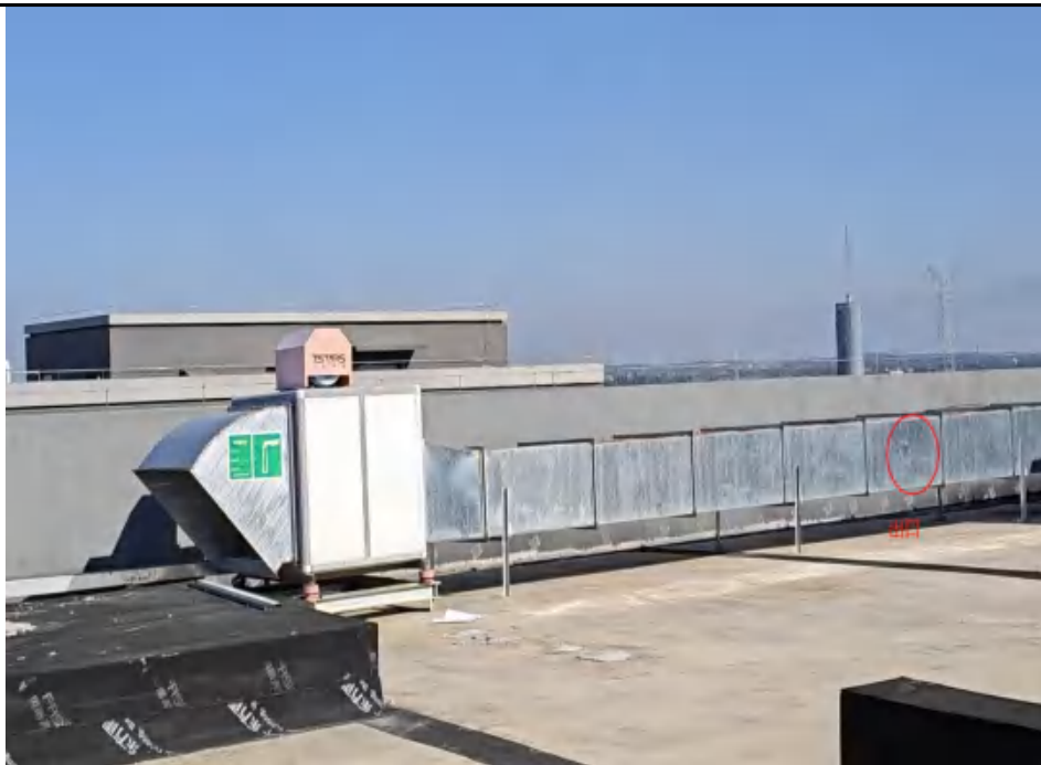
食堂油烟排气筒出口采样孔 1 个
