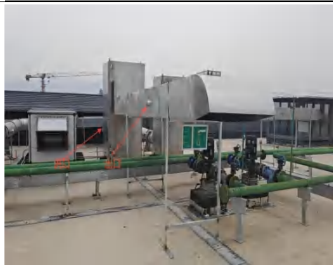
粉尘废气排气筒 DA011 进出口采样孔各 1 个
