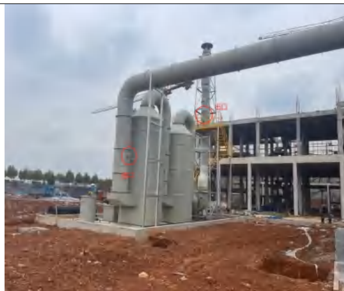
危废仓库废气排气筒 DA002 进出口采样孔各 1 个
