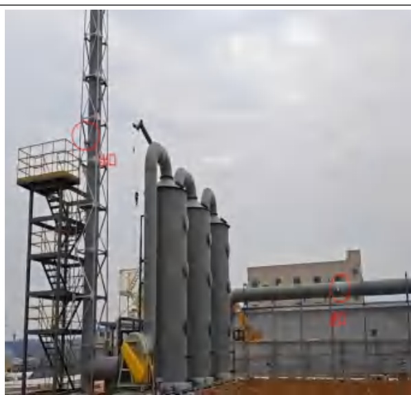
污水站低浓度废气排气筒 DA001 进出口采样孔各 1 个
