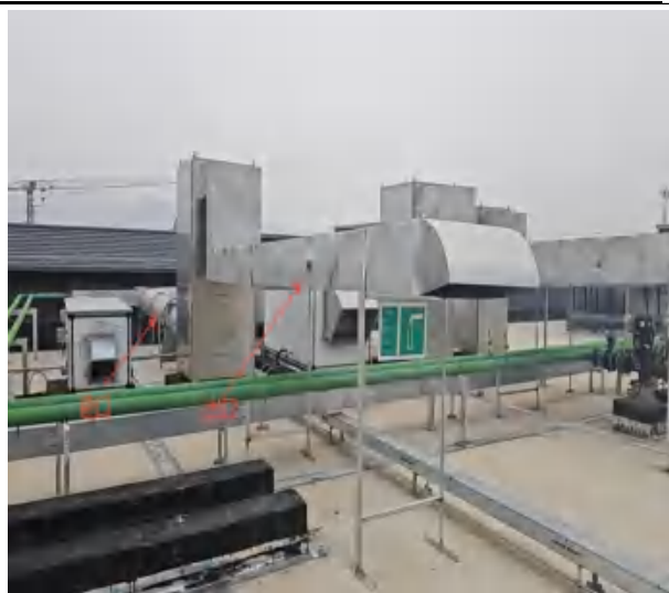
粉尘废气排气筒 DA012 进出口采样孔各 1 个
