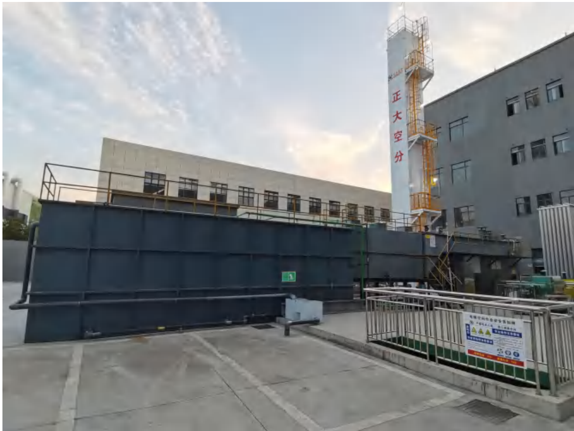
生产废水处理设施
