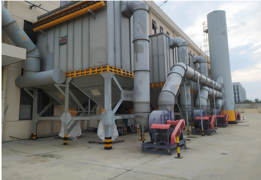
图 4-5 废气治理区照片
