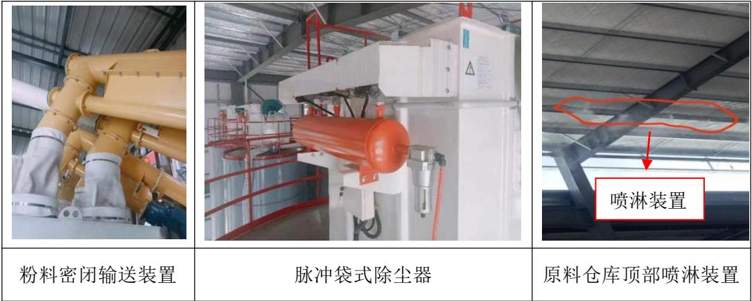
图 4-4 废气治理相关图片
